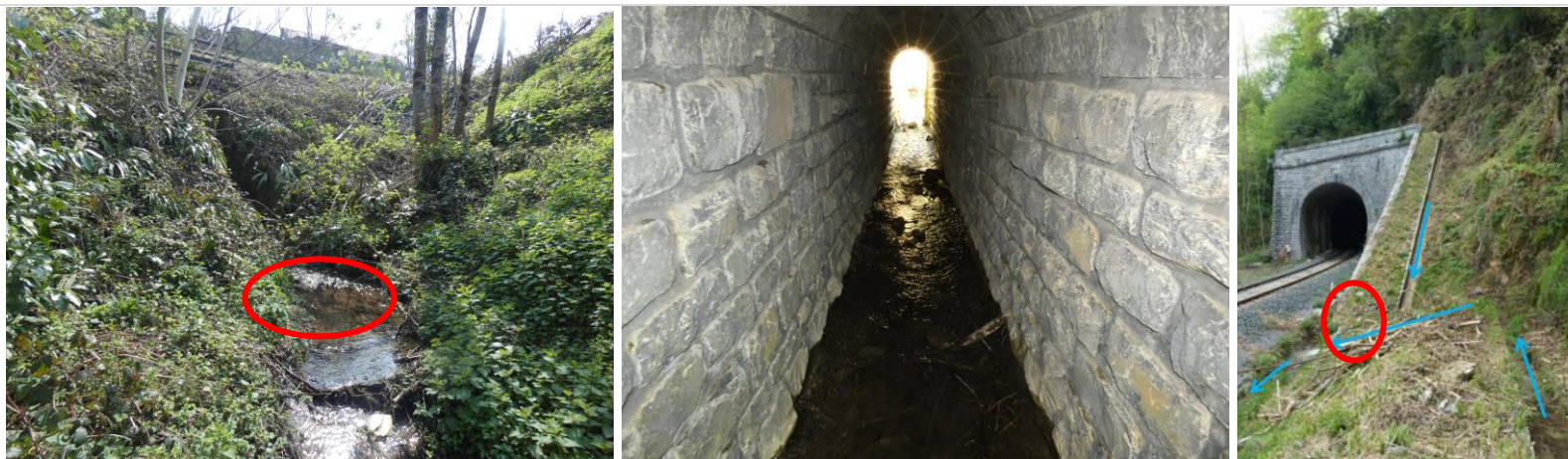
Figure 20 : Mise en place des filtres au niveau du fossé, en sorti du tunnel, au Sud du site d'emprise et à l'intersection entre les descentes d'eau des fossés au plus proche de la falaise [Source : SIMETHIS, 2022 et SNCF, 2020]
