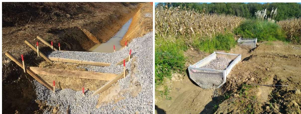
Figure 21 : Exemple de système de filtration (Source : SIMETHIS) 2 - filtre à paille/cailloux, 3 - filtre à cailloux
