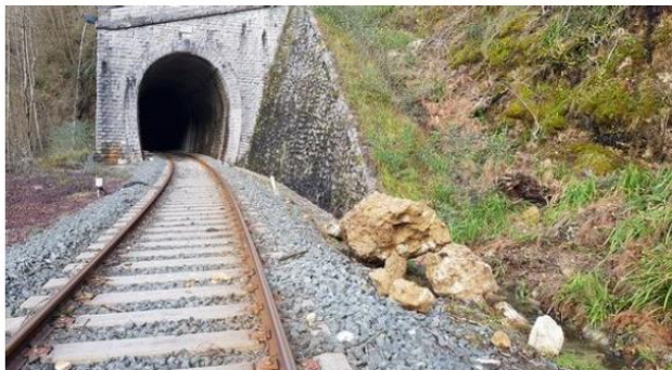
1 février 2021 – Chutes de blocs – vue vers Oloron Volume total d'environ 500 L. Le bloc le plus gros (300 L) s'est arrêté à 1,10 m du rail. Purges en recherche
