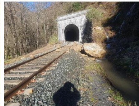
14 décembre 2021- Chute de blocs de 2.5 m3 en zone voie
