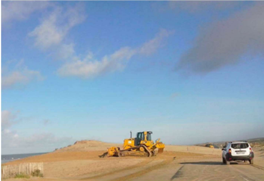
Photos 3 & 4 : chantier mené en 2012-2013 à Vendays-Montalivet, montrant la phase de remodelage (photo 3) puis, ci-dessous, celle de couverture par branchages (Clichés : © ONF)
