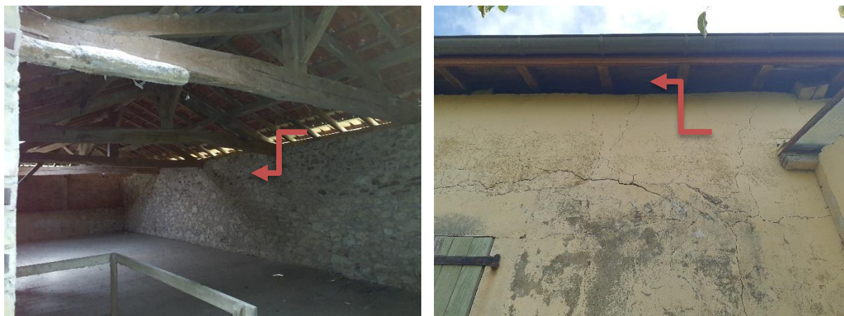
Figure 35 : Entrée des chiroptères sur la façade Ouest (vue de l'intérieur et vue de l'extérieur)
