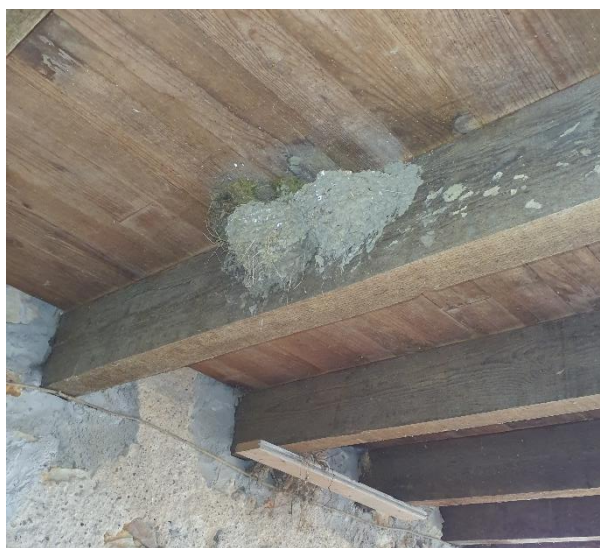
Figure 24 : Nid d'Hirondelle rustique observé sur site
