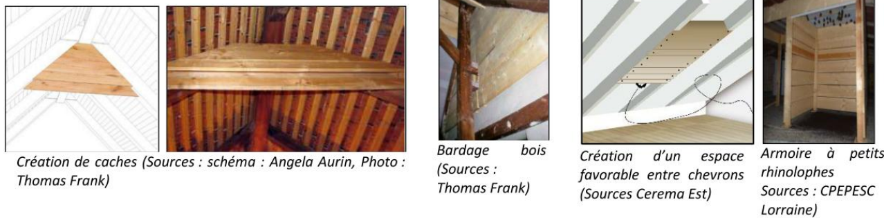
Figure 63 : Aménagements favorables aux chiroptères
