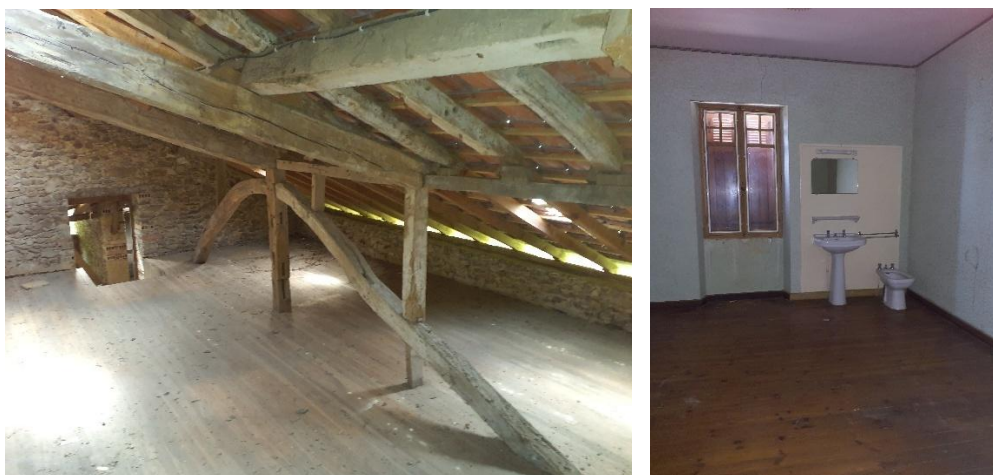
Figure 36 : Charpente de la grange à gauche, pièce en bon état de la maison principale à droite
