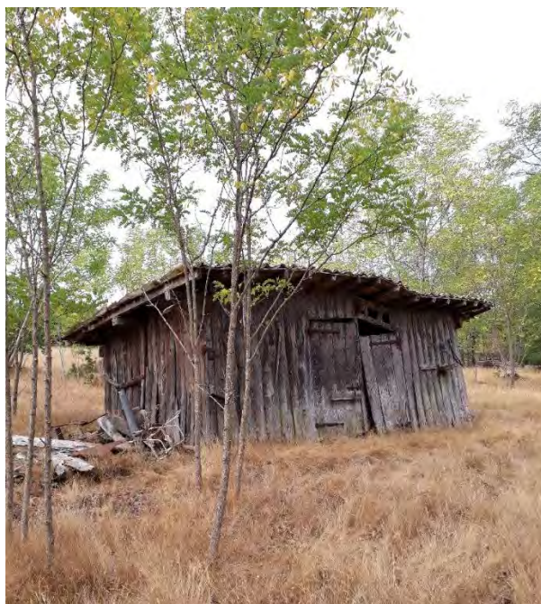
Figure 64 : Cabanon en ruine au niveau de la robineraie
