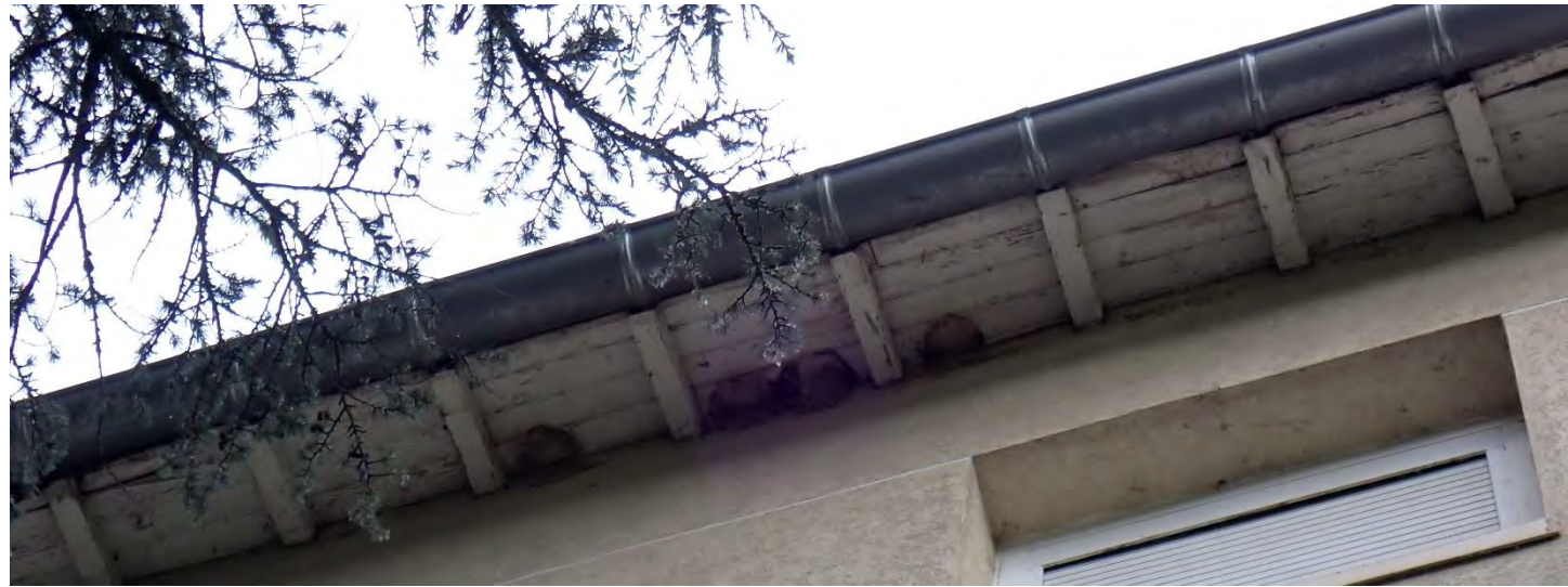
Figure 11 : Toiture du bâtiment C non rénovée par traces d'anciens nids d'hirondelle de fenêtre (photographie prise le 26/04/2024)
