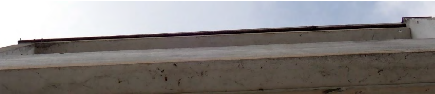
Figure 20 : Fente où sont localisées une partie des Pipistrelles au sein de la façade Sud (13/08/2024)
