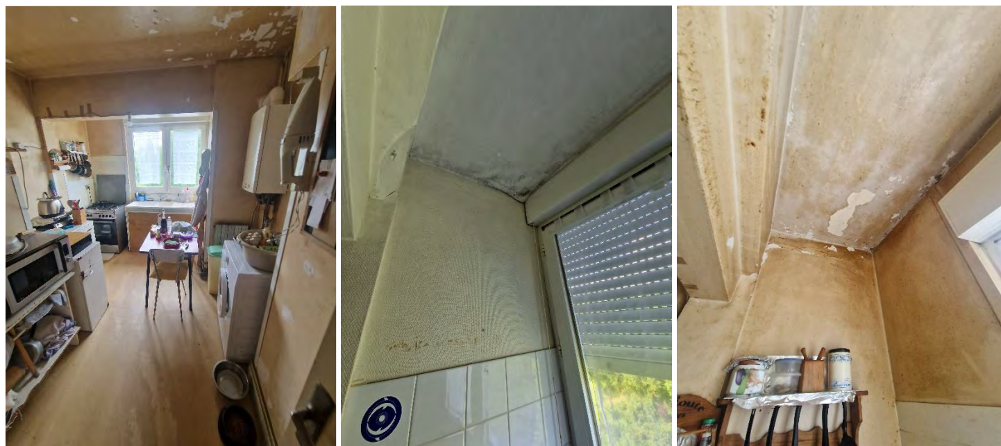
Figure 5 : Photographies de désordre dans les logements liés notamment au manque d'isolation et à l'humidité qui s'est installée dans ces derniers avant rénovation de la résidence (source : Domofrance)
