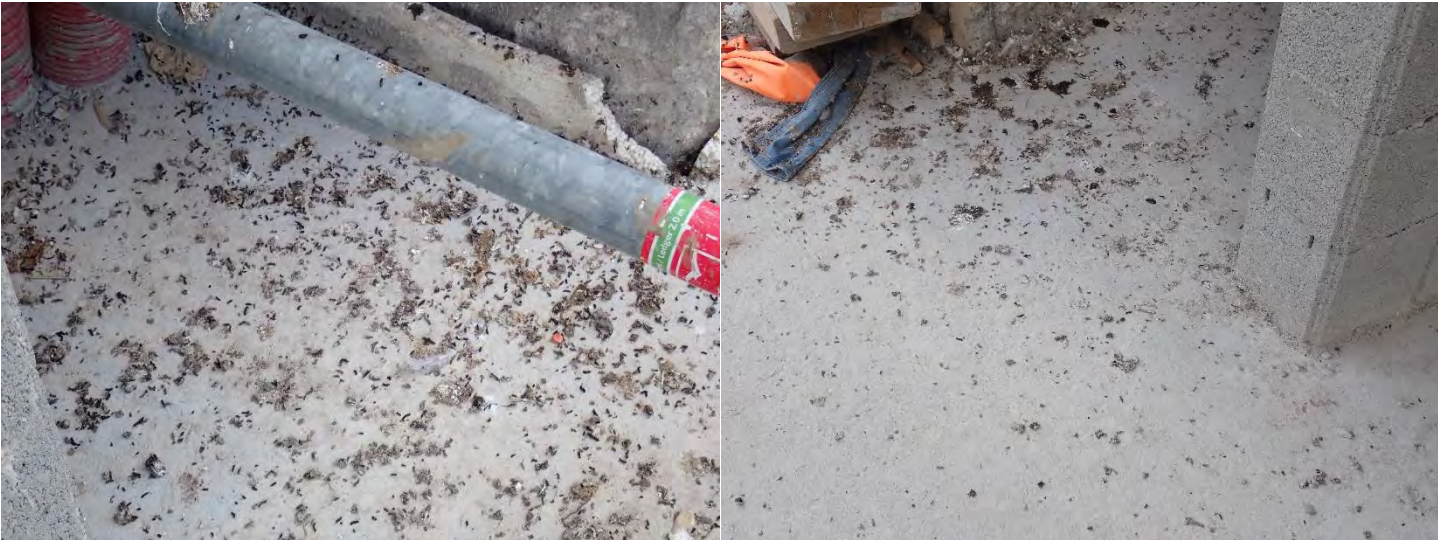
Figure 18 : Tas de guano observé au bas de la façade Sud du bâtiment C (photographies prises le 13/08/2024)
