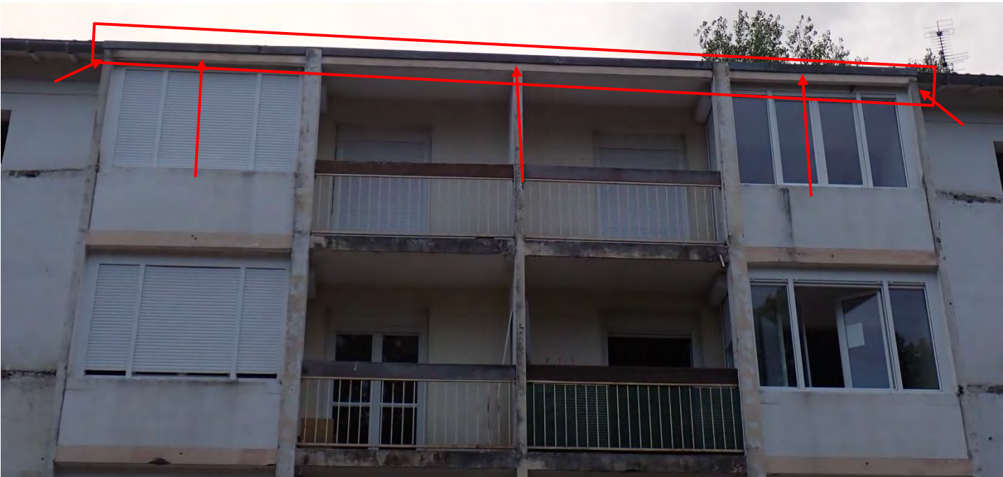
Figure 19 : Fentes favorables aux chiroptères au sein du bâtiment C : exemple d'une partie de la façade sud (13/08/2024)
