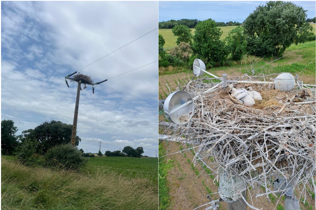
Figures 86 & 87 : Nouvelle construction sur le poteau Moyenne-tension, malgré la présence d'un anémomètre au printemps 2025 (on peut voir qu'un câble central est manquant) à Bel Air, à Saint-Nazaire-sur-Charente (Cédric FAVRIOU / Enedis Poitou-Charentes)
