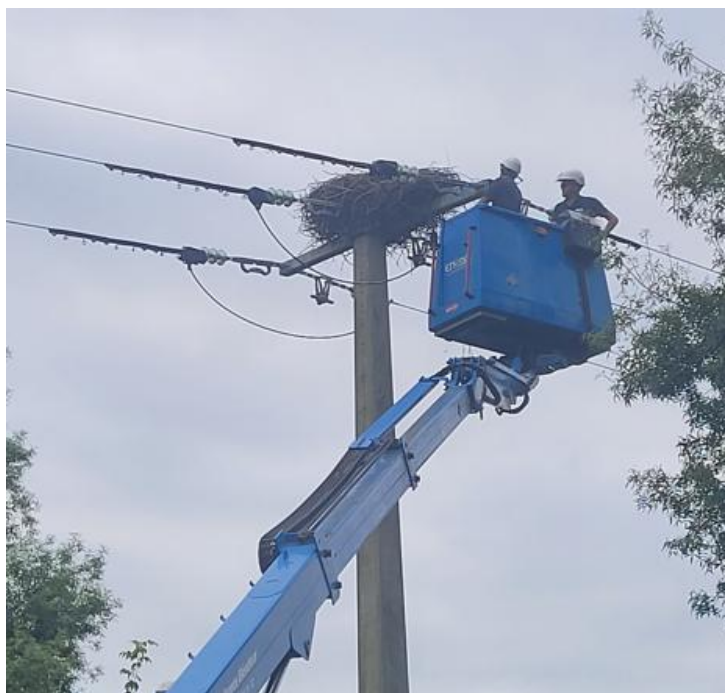
Figure 75: Mise en place de protections isolantes sur un poteau double ancrage HTA comportant un nid de Cigogne blanche (Virginie COUANON / LPO délégation territoriale Aquitaine)
