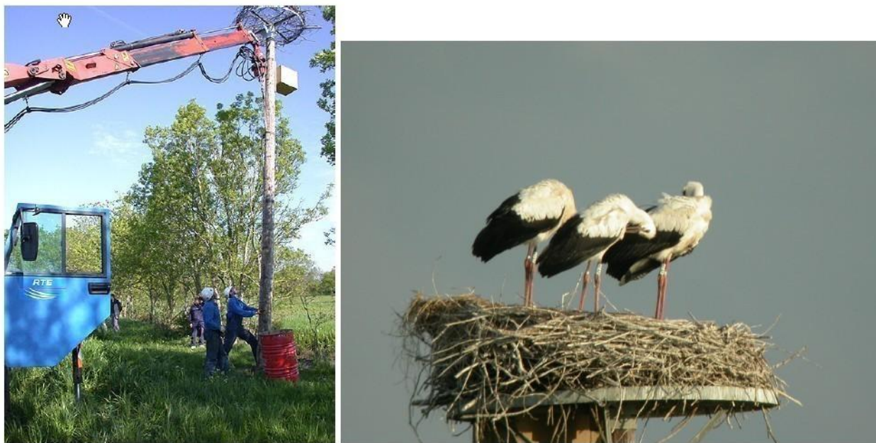
Figures 35 & 36 : Installation d'une plateforme sur mât par RTE et cigogneaux sur plateforme dans le marais d'Audubon en Loire-Atlantique en 2003 (RTE)
