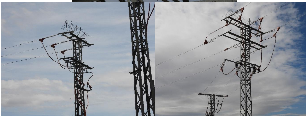
Figures 59, 60 & 61 : Outil préconisé par la LPO depuis 2020 à tester en France, aussi bien sur RTE qu'Enedis, voire SNCF Réseau. Ce dispositif est très fréquent en Espagne (Ici en Navarre). On peut apercevoir sur la photo du bas un nouveau dispositif de protections isolantes, très couramment utilisées en Espagne (Nicolas CROIZE / LPO).
