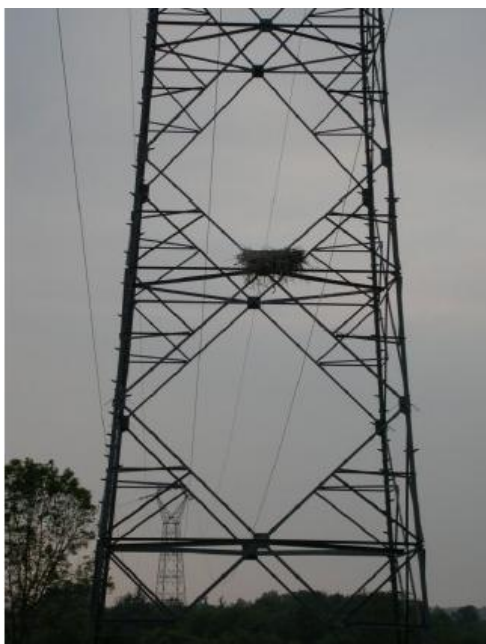
Figure 37 : Nid dans un fût de pylône (RTE)
