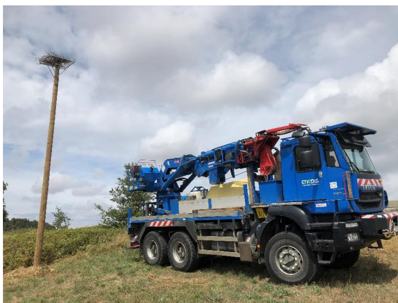
Figure 23 : Installation d'une plateforme sur mât par Enedis Poitou-Charentes en Charente-Maritime (Nicolas GENDRE / LPO)
