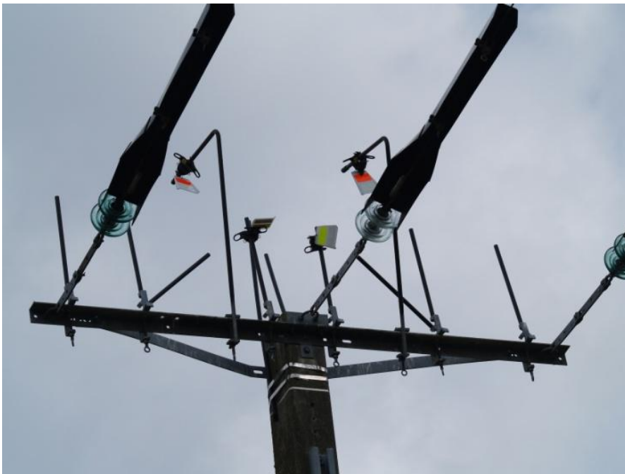
Figure 21 : Dispositif installé sur un poteau électrique pour empêcher l'oiseau de revenir nicher après le déplacement de son nid (2012), avant l'adoption de l'anémomètre par Enedis Poitou-Charentes (Nicolas GENDRE / LPO)
