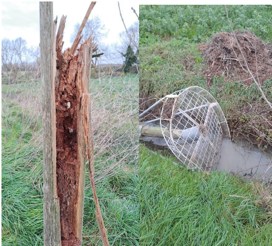
Figures 84 & 85 : Poteau cassé de la plateforme installée en 2014 et tombée lors de l'automne 2024 à Bel Air, à Saint-Nazaire-sur-Charente (Cédric FAVRIOU / Enedis Poitou-Charentes)
