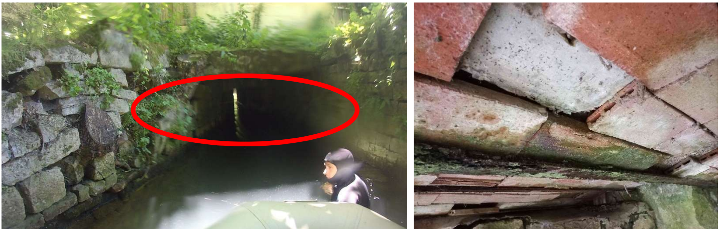
Figure 27 : les matériaux de couverture des canaux seront laissés en état (dalles de pierres, voûtains de briques)
