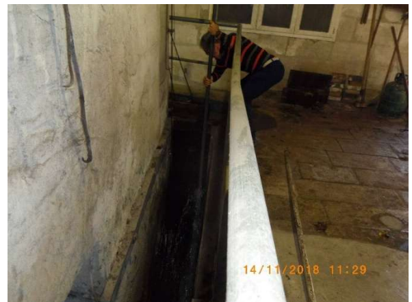
Manœuvre des batardeaux (en 2018)
