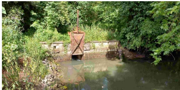
Vanne de décharge
