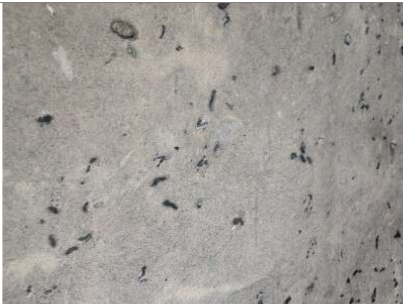
Figure 5: Projections de guano sur les murs du 2ème étage
