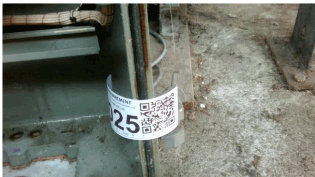
002ER485347-3 n°25 - 1 (P25) - Équipements - Vol 18 (Transformateur 2)
