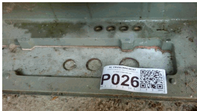
002ER485347-3 n°26 - 1 (P26) - Équipements - Vol 18 (Transformateur 2)
