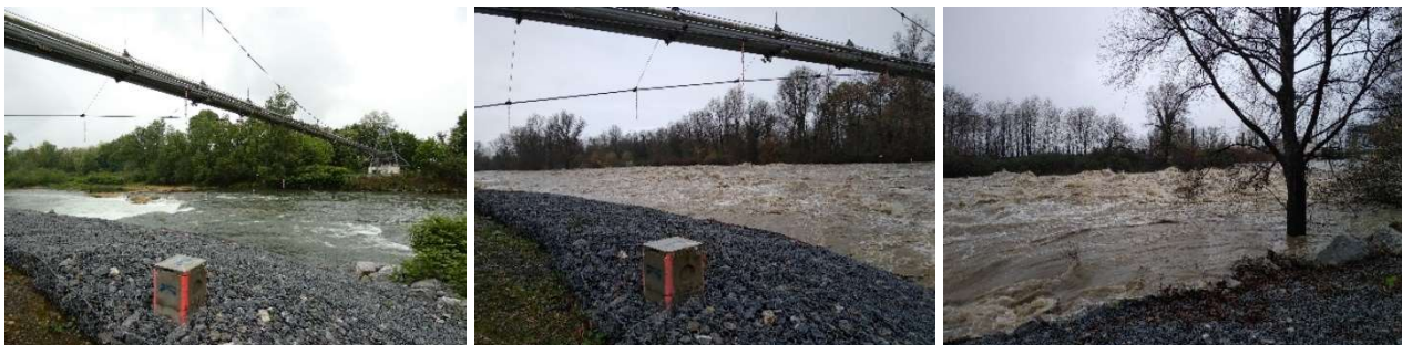
Figure 11 : Renforcement des sorties de terre en période d'eau calme (à gauche) et en période de crue (au milieu et à droite) [Source : SIMETHIS, 2021]
