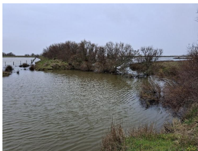
Vue de la zone érodée - Photo prise en mars 2026
