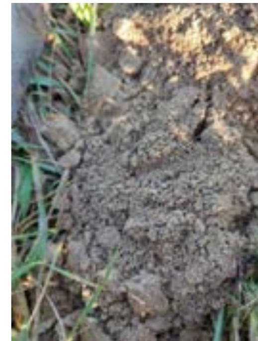
Figure 36 : Très légères traces de fer oxydé observées sur le sondage S5 © ETEN Environnement
