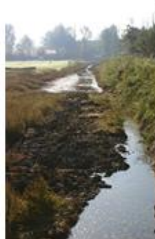
Partie aval de la noue, partiellement effondrée
