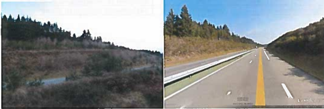
Vue de l'accès possible via le chemin forestier ; vue d'ensemble de l'ouvrage et du remblai disponible
