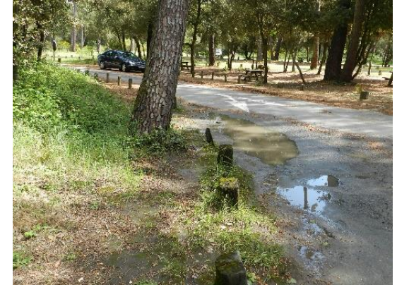
Voie d'accès à mettre hors d'eau (évacuation des eaux pluviales)
