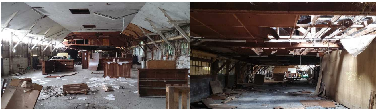
Vue de l'intérieur du hangar nord : de nombreux espaces en hauteur sont inaccessibles
