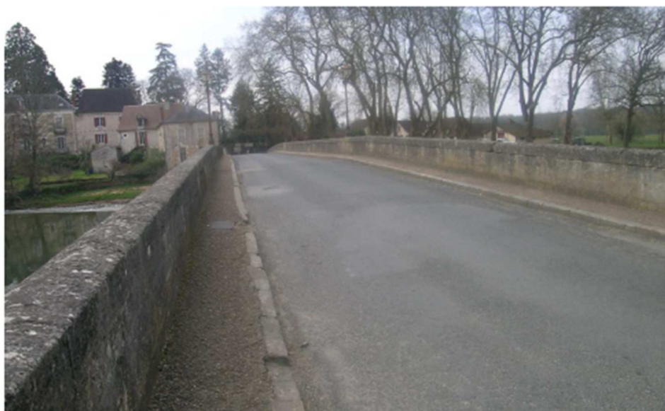
Vue générale du tablier de l'ouvrage : étanchéité défailante.
