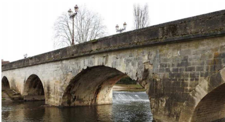
Voûte n°6 : bandeau fortement dégradé.
