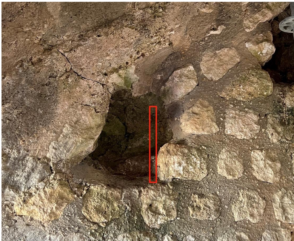
Figure 21 Localisation du positionnement d'une faille à créer à l'entrée d'un trou de boulin
