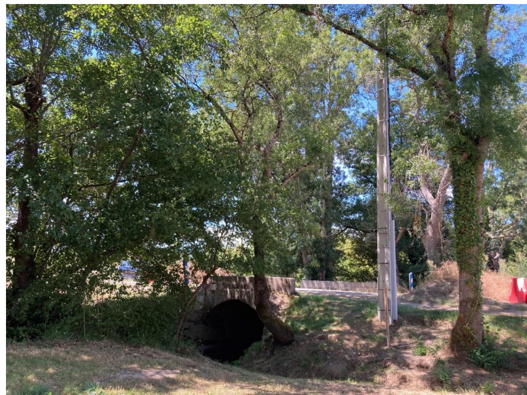
Figure 30 : Photo 1 – Berges nord-est
