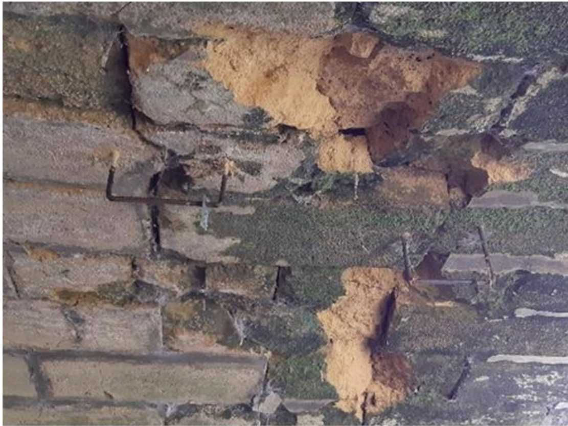
Figure 9 : Fissures au niveau de la voûte
