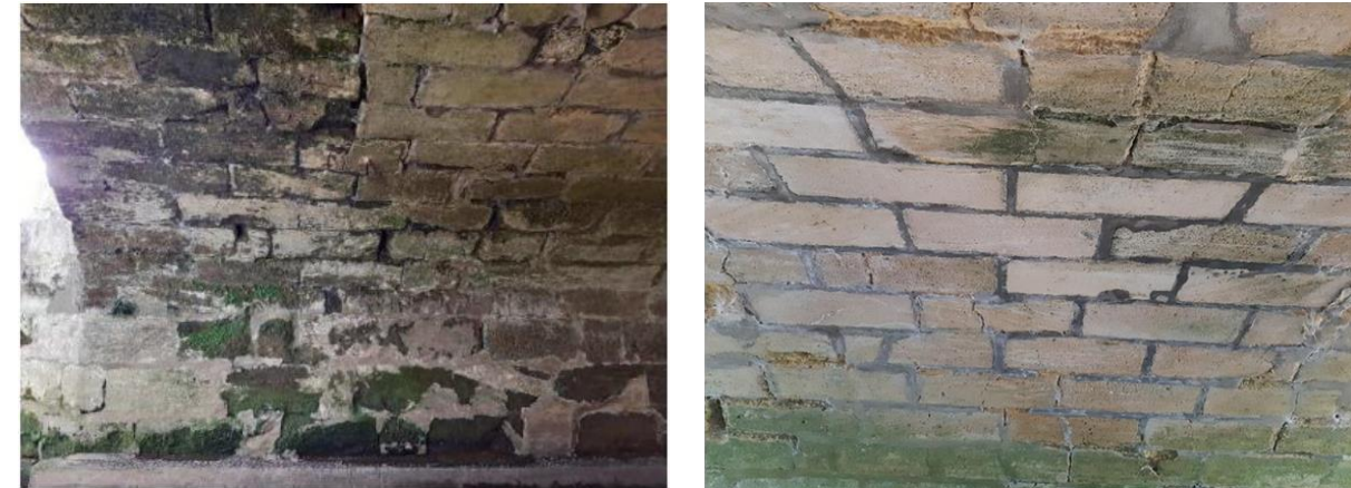
Figure 7 : Maçonnerie désorganisée et dis jointement de la voûte
