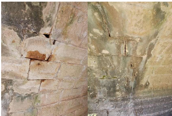
Figure 3 : Exemple de cavités observées sous la voûte 1 (à gauche) et la voûte 2 (à droite).
