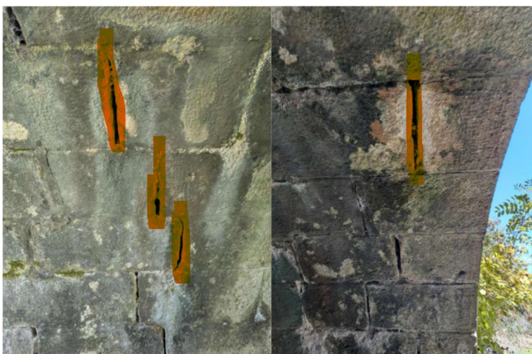
Figure 5 : Localisation des fissures présentant des individus de chiroptères au second passage (voûte 2).
