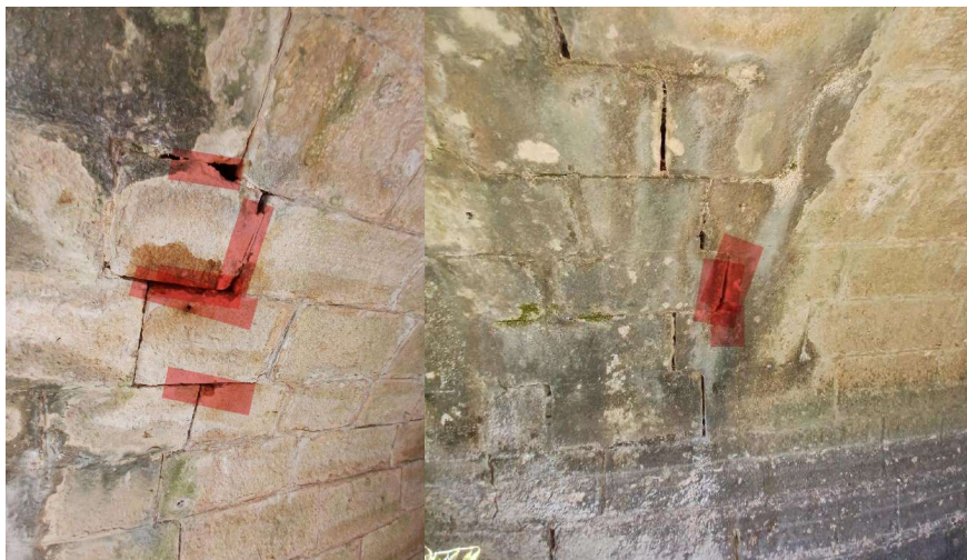
Figure 4 : Localisation des fissures présentant des individus de chiroptères au premier passage (voûte 1 à gauche et voûte à droite).
