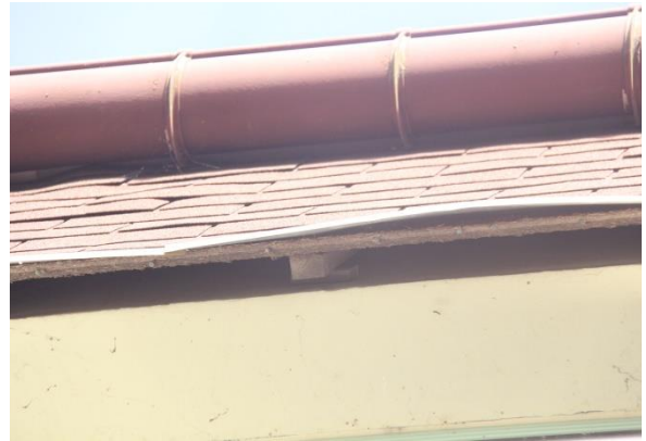
Photo : Absence de grille donnant accès à l'espace sous le bardage
