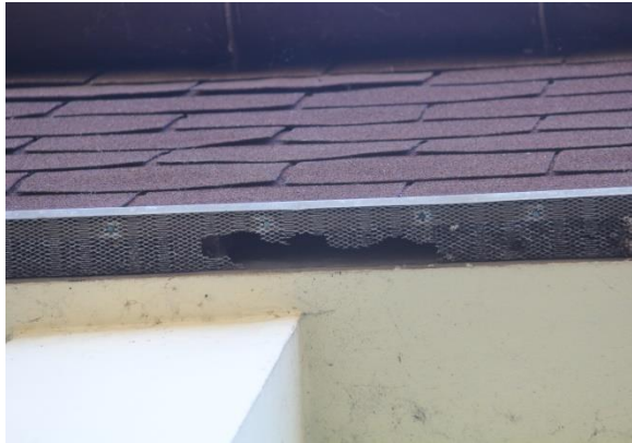
Photo : Grille détériorée donnant accès à l'espace sous le bardage
