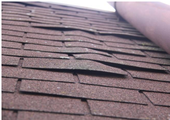
Photo : Plaques de bardeau bitumé soulevées
