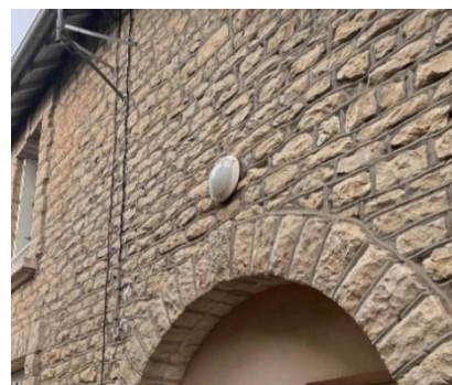
Figure 43 : Type d'éclairage lumineux en place sur les bâtis 1 à 6
