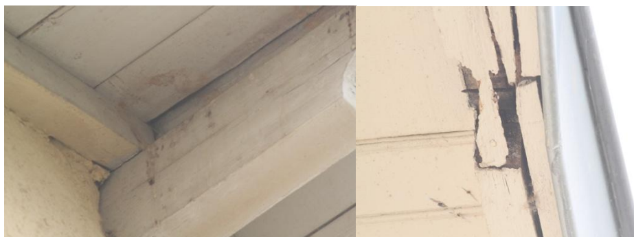
Figure 39 : Interstices favorable au passage des chiroptères au sein de l'avant-toit du bâtiment 5
