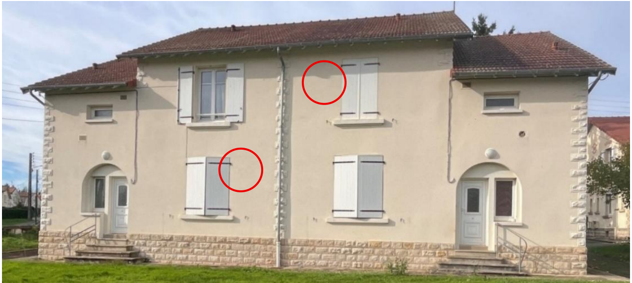
Figure 31 : Localisation du guano de chauve-souris derrière 2 volets de la façade est bâtiment 4
