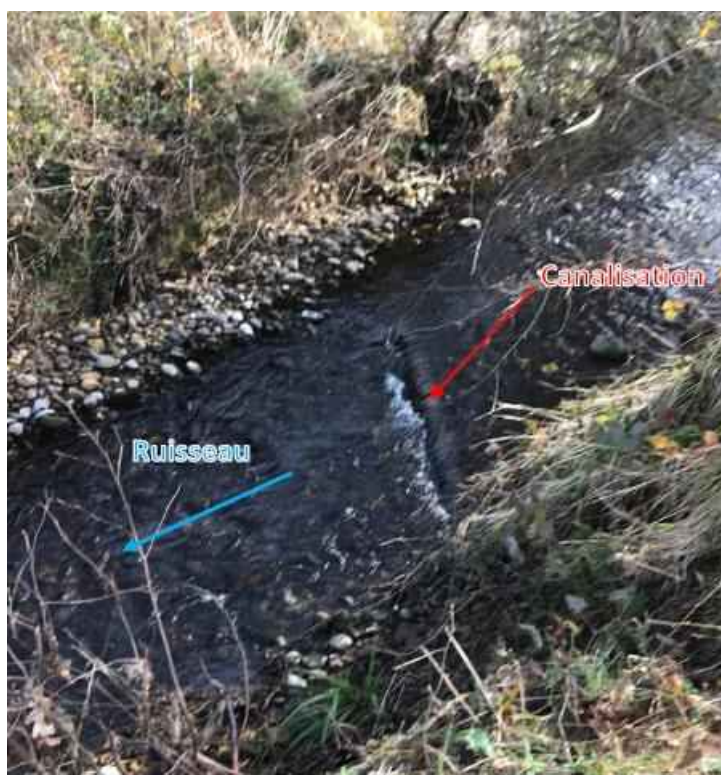
Figure 19 : Traversée de la Baysère avec effet seuil de la canalisation (Point 2-6) (Source : ARTELIA)
