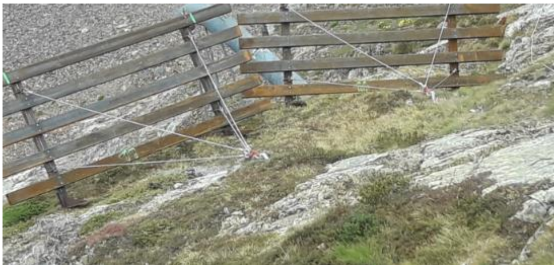
Figure 10 Photo d'installation de claies à neige (source : Bruzy A., RTM, 2022)
