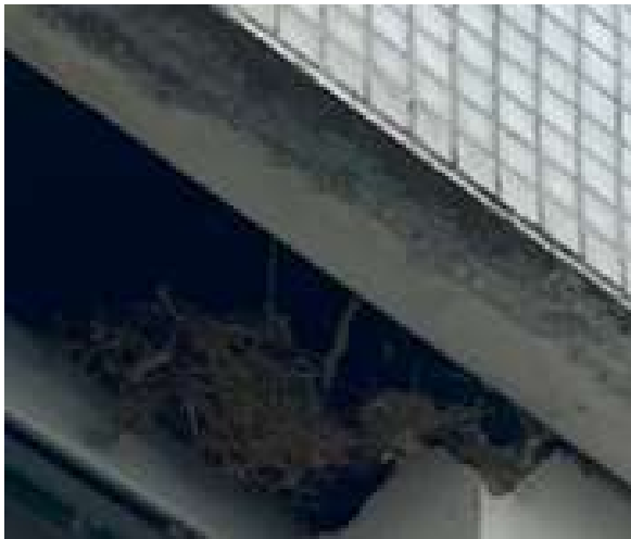
Zoom sur nid de martinets dans un coffre de volet roulant existant
