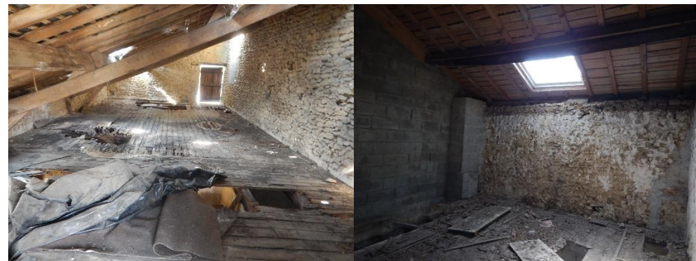
Figure 24 : A gauche, comble à la couverture très dégradée du bâtiment F ; à droite pièce sous comble avec fenêtre de toit du bâtiment K
