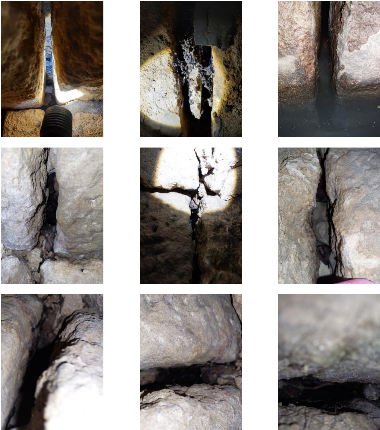
Photo. 17 : exemple de présence d'anfractuosité entre les pierres du pont 8 (O-GEO, 28/06/2024)
