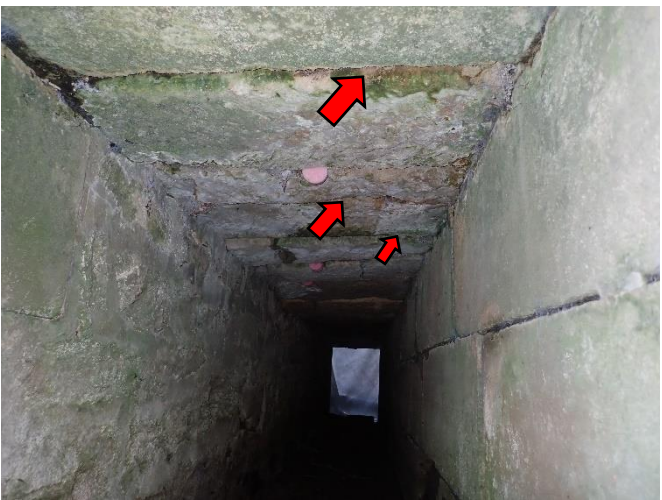
Photo. 26 : voute du pont, disjointements entre les dalles et localisation des individus (O-GEO :04/09/2024)
