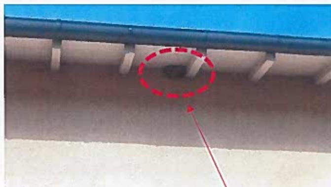
1 nid sous l'avant-toit de la façade Est
