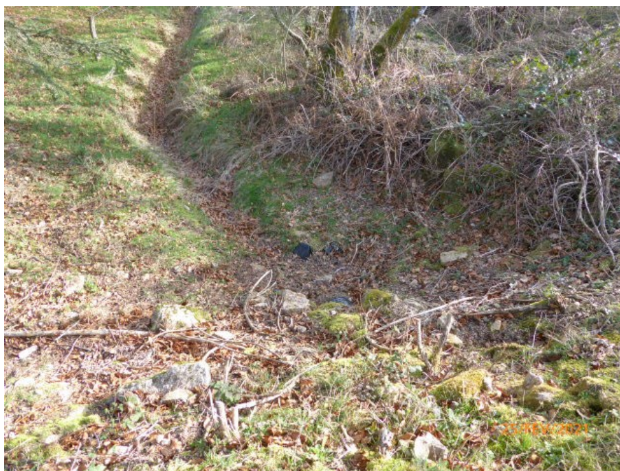
Figure 8 : un des fossés de dérivation des eaux pluviales au nord de la MCO
