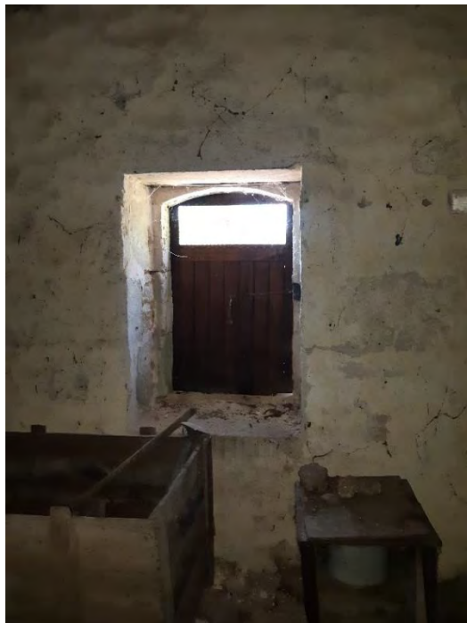
Fenêtre de combles de la maison Audiat à combler
