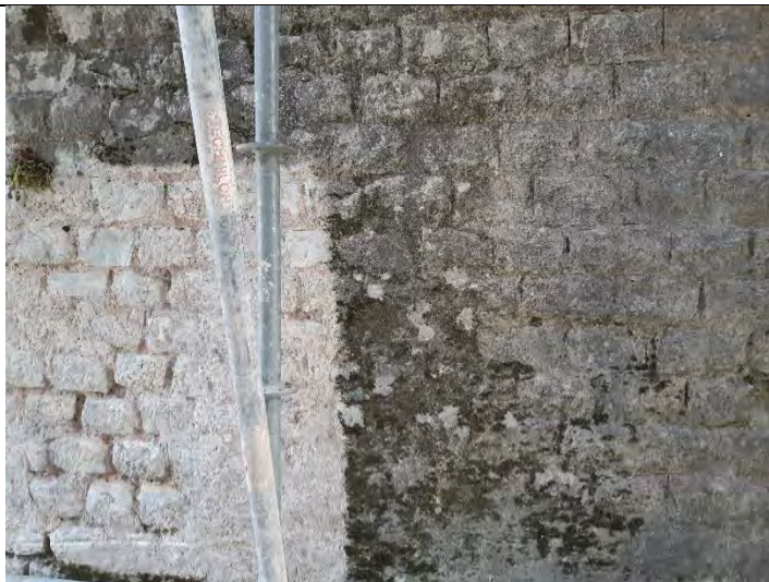
Figure 45 Exemple d'une partie traitée avec le procédé précédemment décrit et une partie non traitée (source : ECR environnement)
