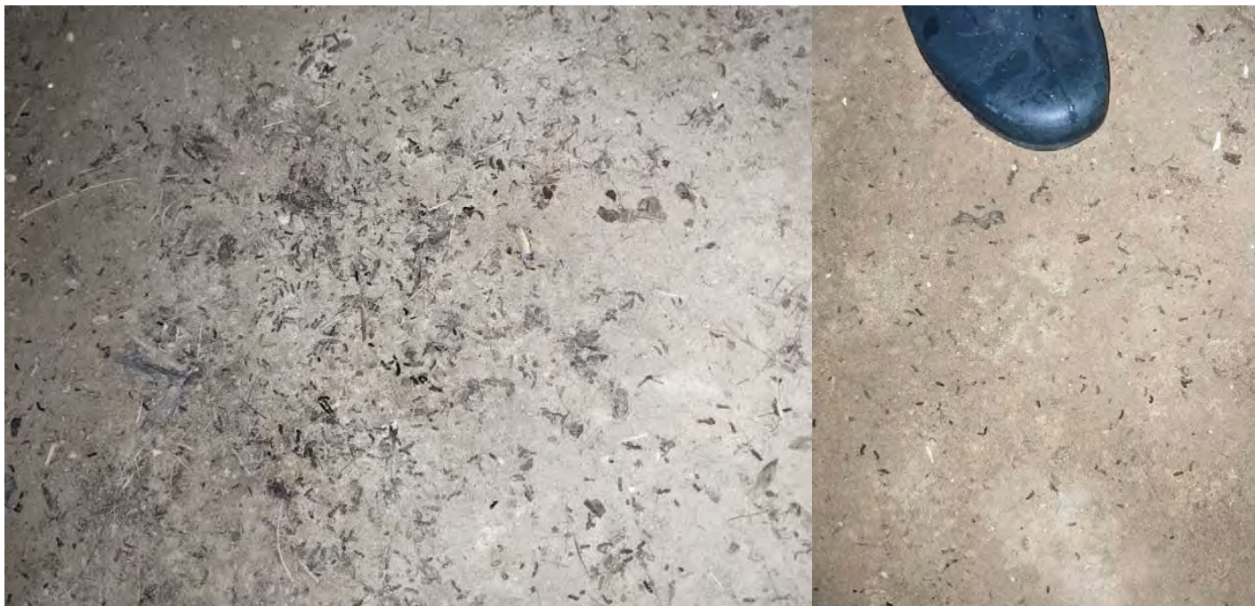
Photo 8 : Guano localisé dans le garage (Source : SIMETHIS, sur site)
