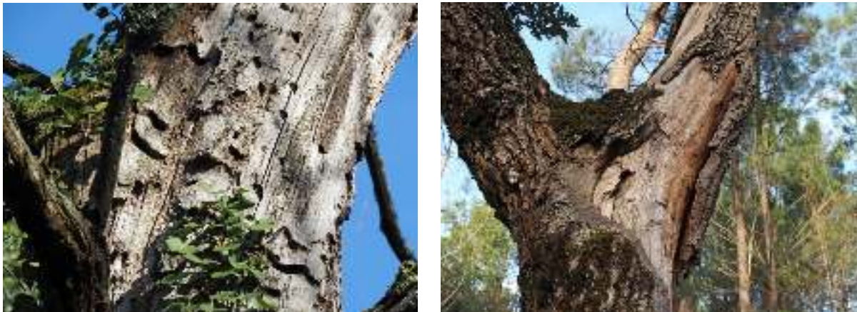
Figure 61 : Photographies des trous de sortie sur site
