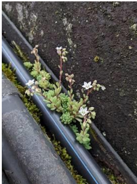
Figure 30 : 4 individus d'orpins se sont installés à même la conduit dans des accumulations d'humus
