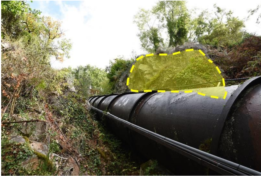
Figure 27 :. Etendue de la station d'Orpin hérissé sur le secteur amont, déjà sécurisé
