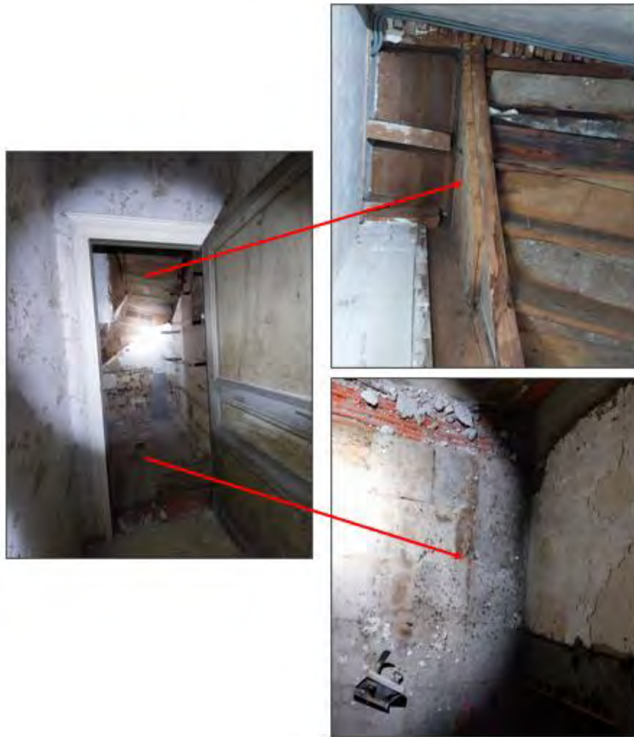
Figure 50 : Crottes présentes au niveau d'un dessous d'escalier
