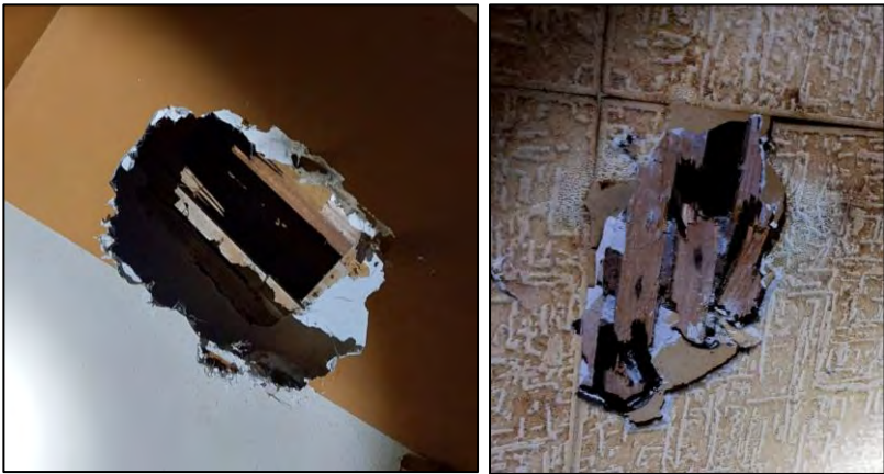
Figure 26 : Exemples de trouées présentes au niveau des faux plafonds
