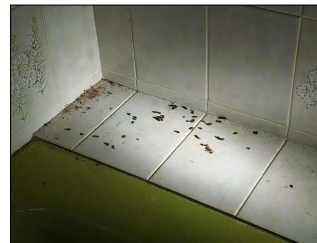
Figure 52 : Crottes présentes au niveau de la salle de bain à l'étage
