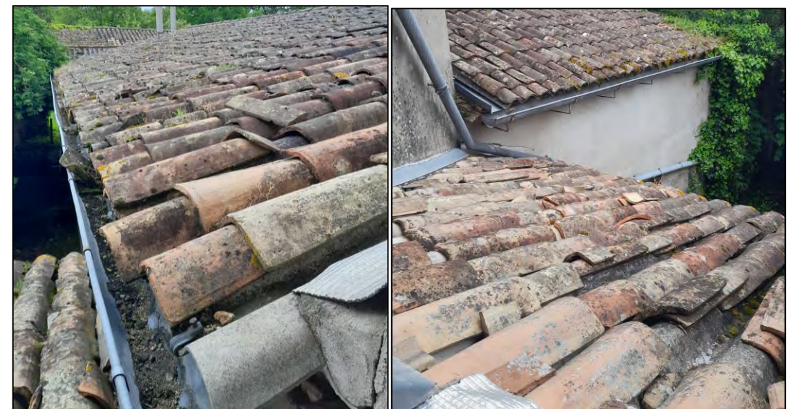
Figure 47 : Tuiles présentes sur les bâtiments comportant de nombreux espacements favorables
