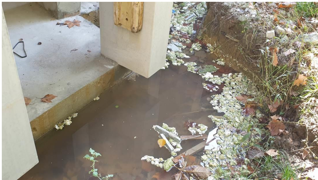
Eau stagnante au pied du bâtiment
