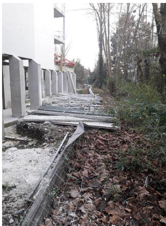
Échafaudages entreposés, écrasant la clôture à amphibiens janvier 2021
