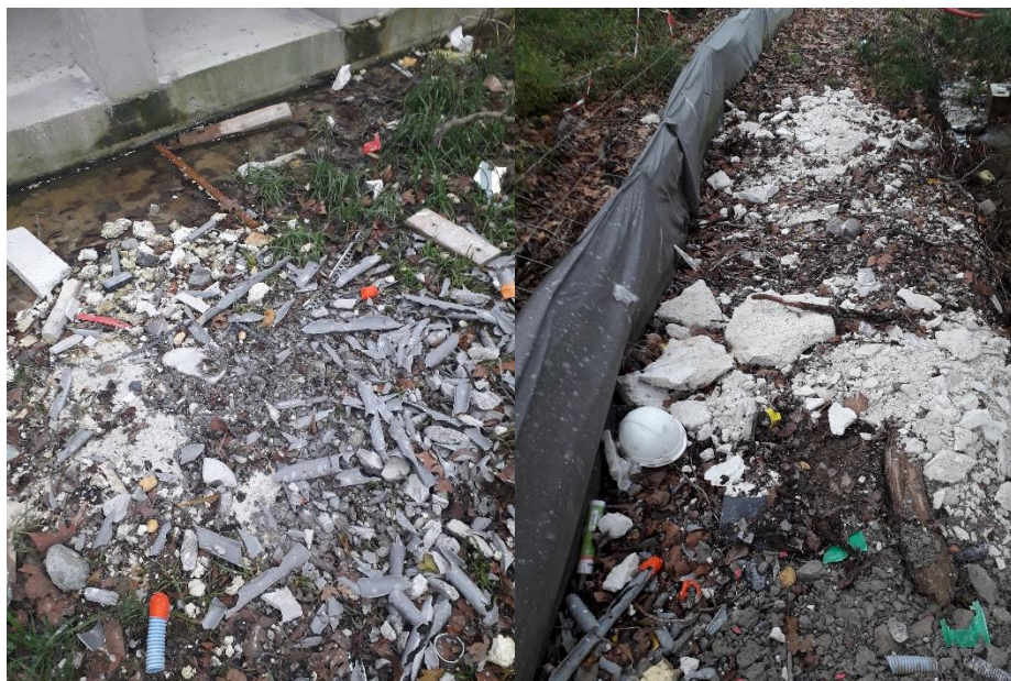
Débris de chantier Janvier 2021
