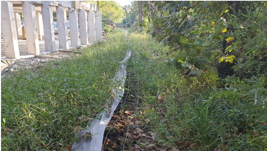
Clôture affaissée par le poids de la végétation
