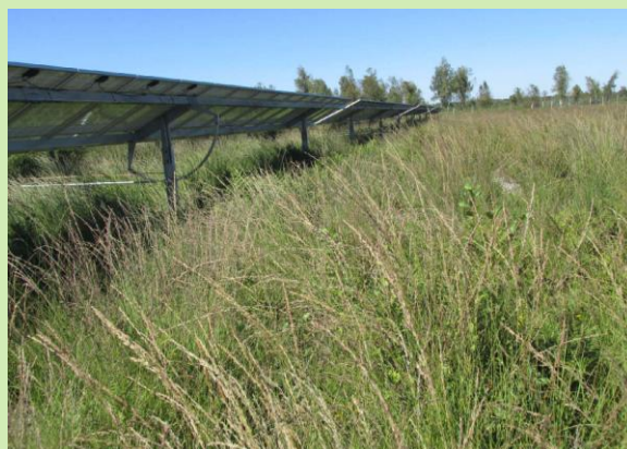
Panneaux en exploitation (source : NEOEN)
