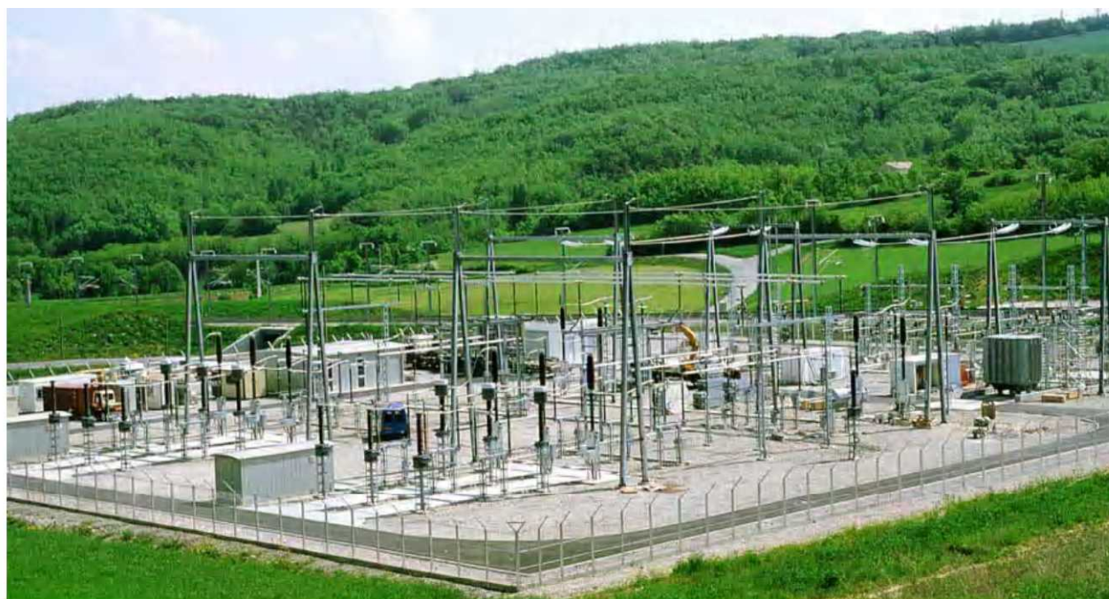
Figure 28 - Exemple de sous-station électrique
