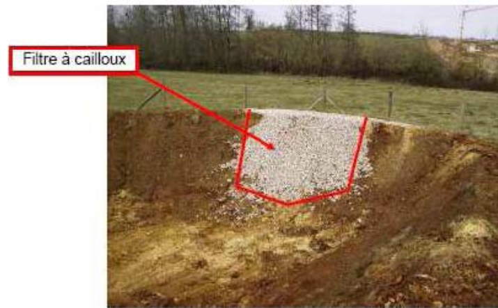
Filtre à cailloux
