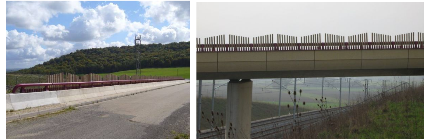
Figure 65 : Exemple de haies de poteaux installées sur un pont route pour le guidage des chiroptères
