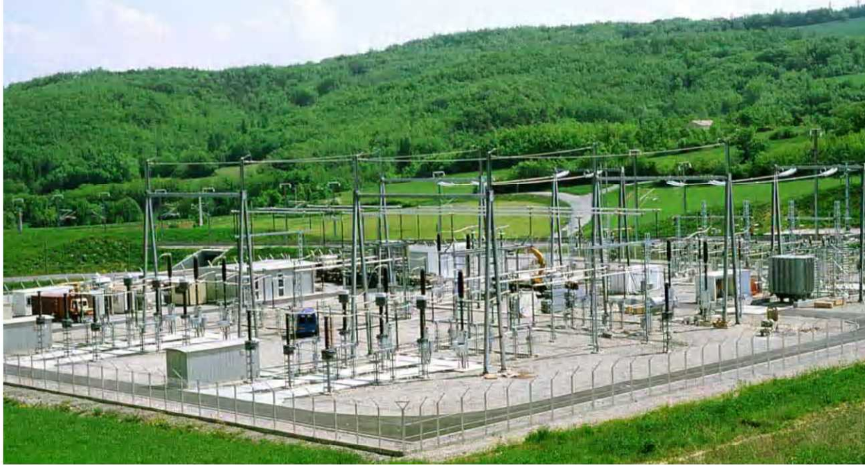
Figure 28 - Exemple de sous-station électrique
