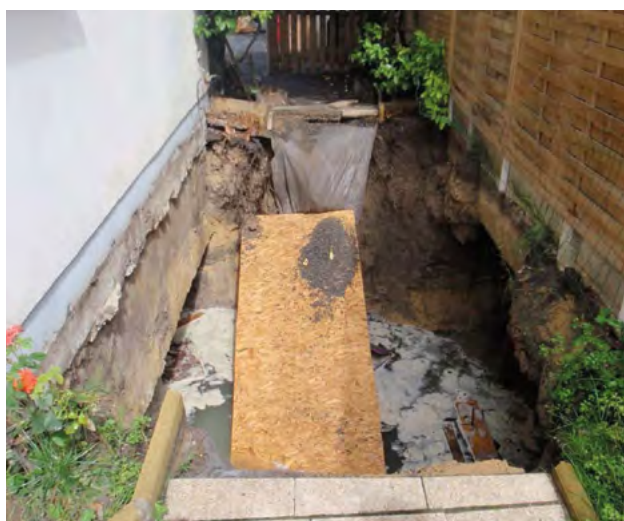
Photographie 2 : fontis d'environ 4 m de diamètre et plus de 5 m de profondeur observé à Sevran (Seine-Saint-Denis, 93) en 2014 (Crédit IGC)
