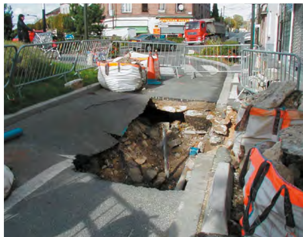
Photographie 8 : effondrement observé sur la commune de Villeteuse en lien avec la fuite du réseau d'assainissement (source : Cerema, juillet/octobre 2004)
