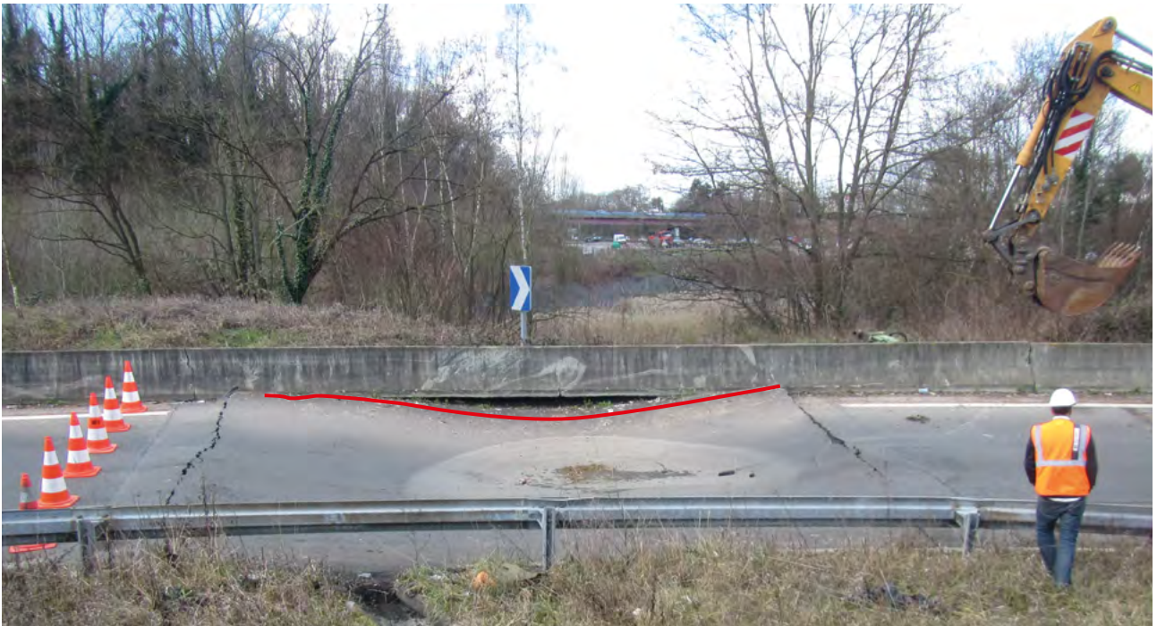
Photographie 6 : affaissement de 8,5 m x 9,5 m ayant engendré le fléchissement (en rouge) de la chaussée, observé sur la bretelle de l'autoroute A15 à hauteur de Franconville (Val d'Oise, 95) en 2014 (Crédit Cerema)
