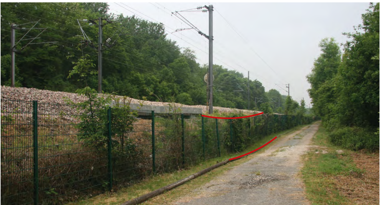
Photographie 7 : affaissement observé le long du chemin latéral du bois de la Tussion (Seine-Saint-Denis, 93) en 2010. En rouge, la zone paroxysmale présentant un déplacement vertical cumulé pluricentimétrique (Crédit INERIS)
