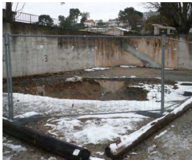
Photographie 3 : fontis de 6 m de diamètre et 6,5 m de profondeur observé à Draguignan en 2013 (Rivet et al., 2014)
