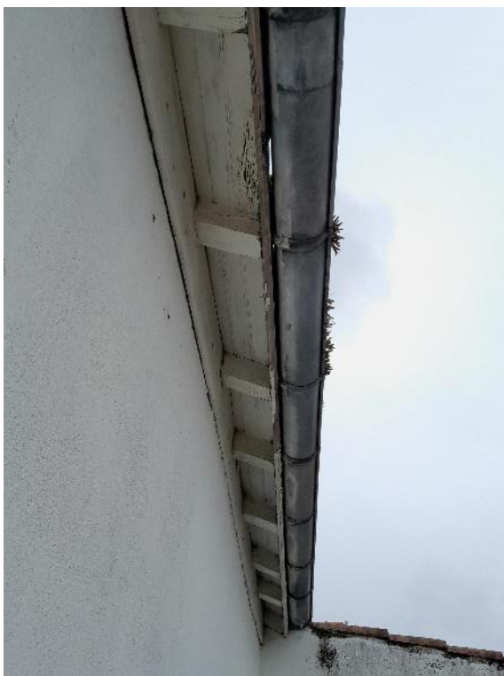
Photo 12: Debord toiture dépendance façade Sud
