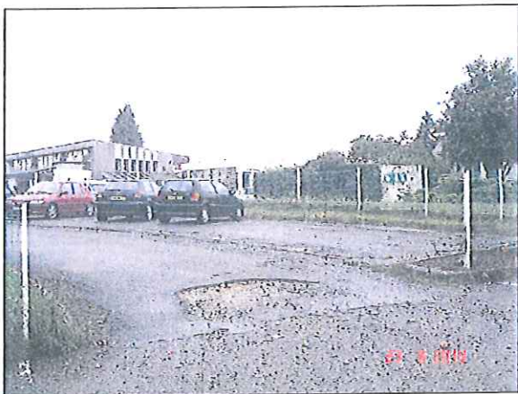
Photo 3. Dégradation à l'entrée du parking estimée sans liaison avec les travaux miniers
