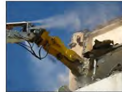
Exemple de brumisation en bout de flèche
