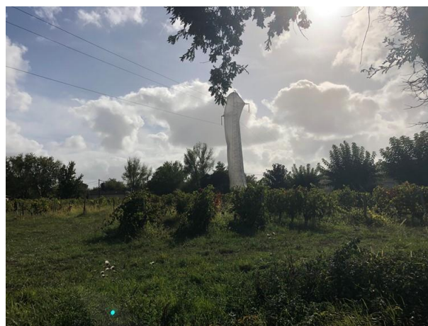
Figure 23 : Pylône avec une bâche verticale
