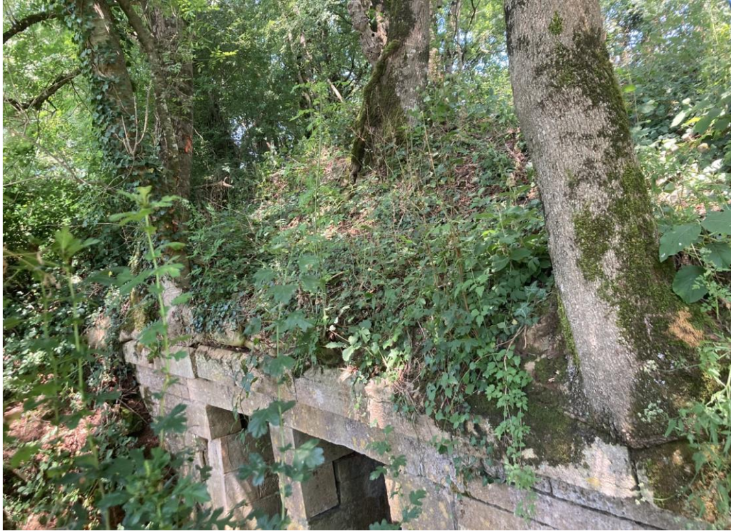
Figure 1: Frênes dont les racines déchaussent l'ouvrage
