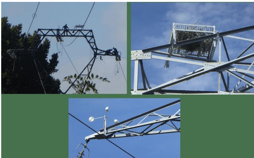
Figures 23, 24 & 25 : Plateforme surélevée pour Cigogne blanche et anémomètre en Charente-Maritime (RTE)
