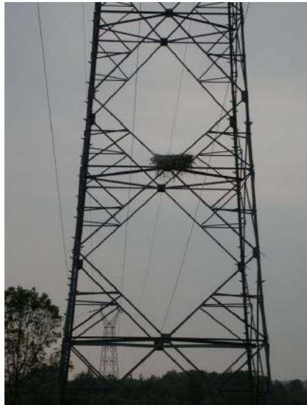
Figure 17 : Nid dans un fût de pylône (RTE)
