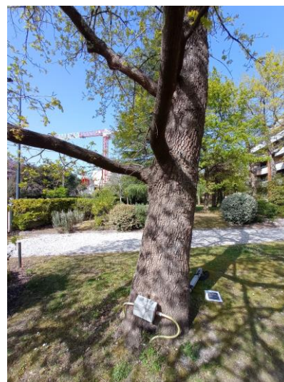
Photo n°10 : installation électrique (arbre n°18)
