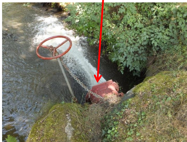
Vidange DN 400 alimentant le bief du moulin de Pinard
