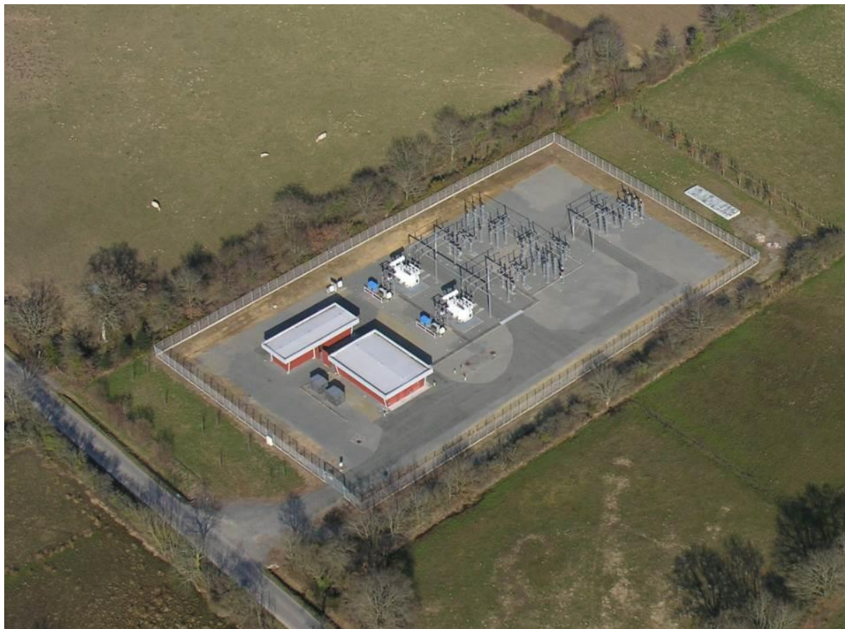
Exemple de poste de transformation
