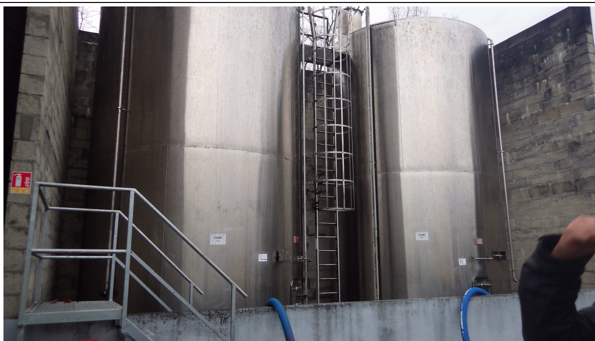
Figure 17 : Murs de protection autour des cuves 15 et 16 de la distillerie charentaise
