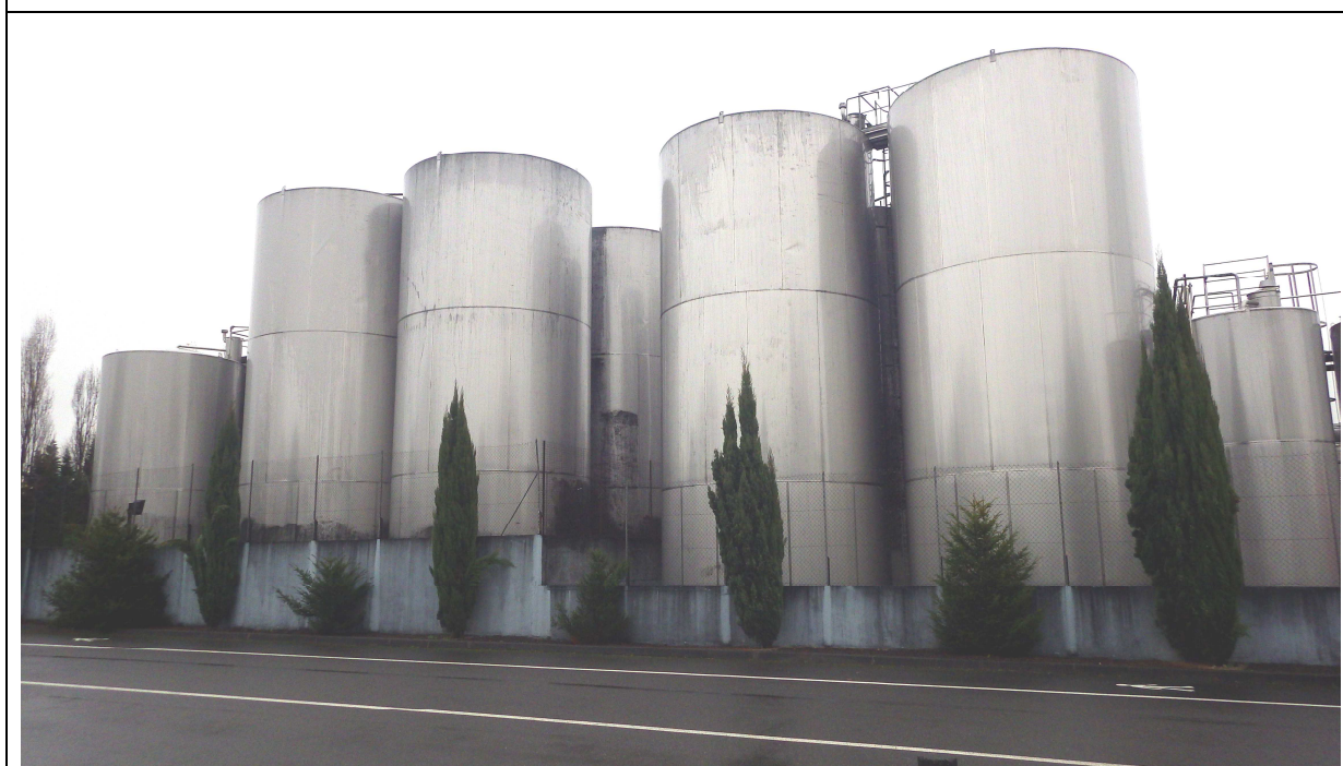
Figure 12 : Parc n°2 – Cuveries alcools de la distillerie à colonne
