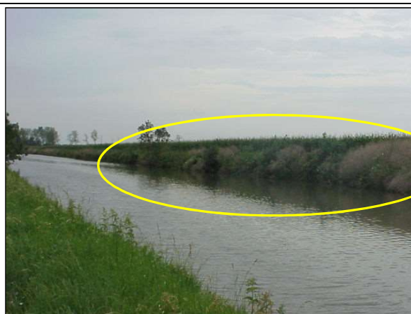
Effondrement de berge en amont de la Hutte du Gros Vergne
