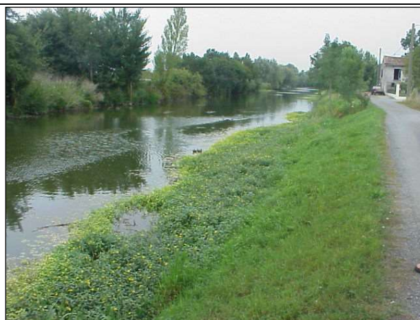
Développement de la végétation arborée dans le corps de digue.
