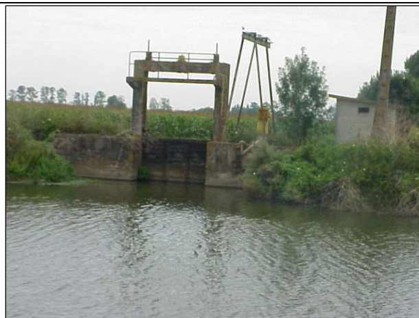
Vanne et station de pompage de Marans. De l'érosion au droit du Génie civil en bordure du cours d'eau
